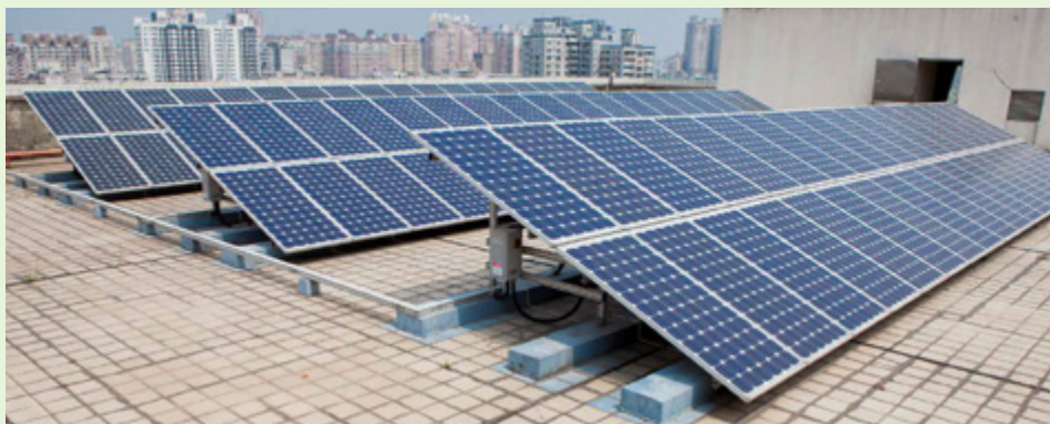
高市府鳳山行政中心裝設光電走廊與光電屋頂，可節省大筆電費
