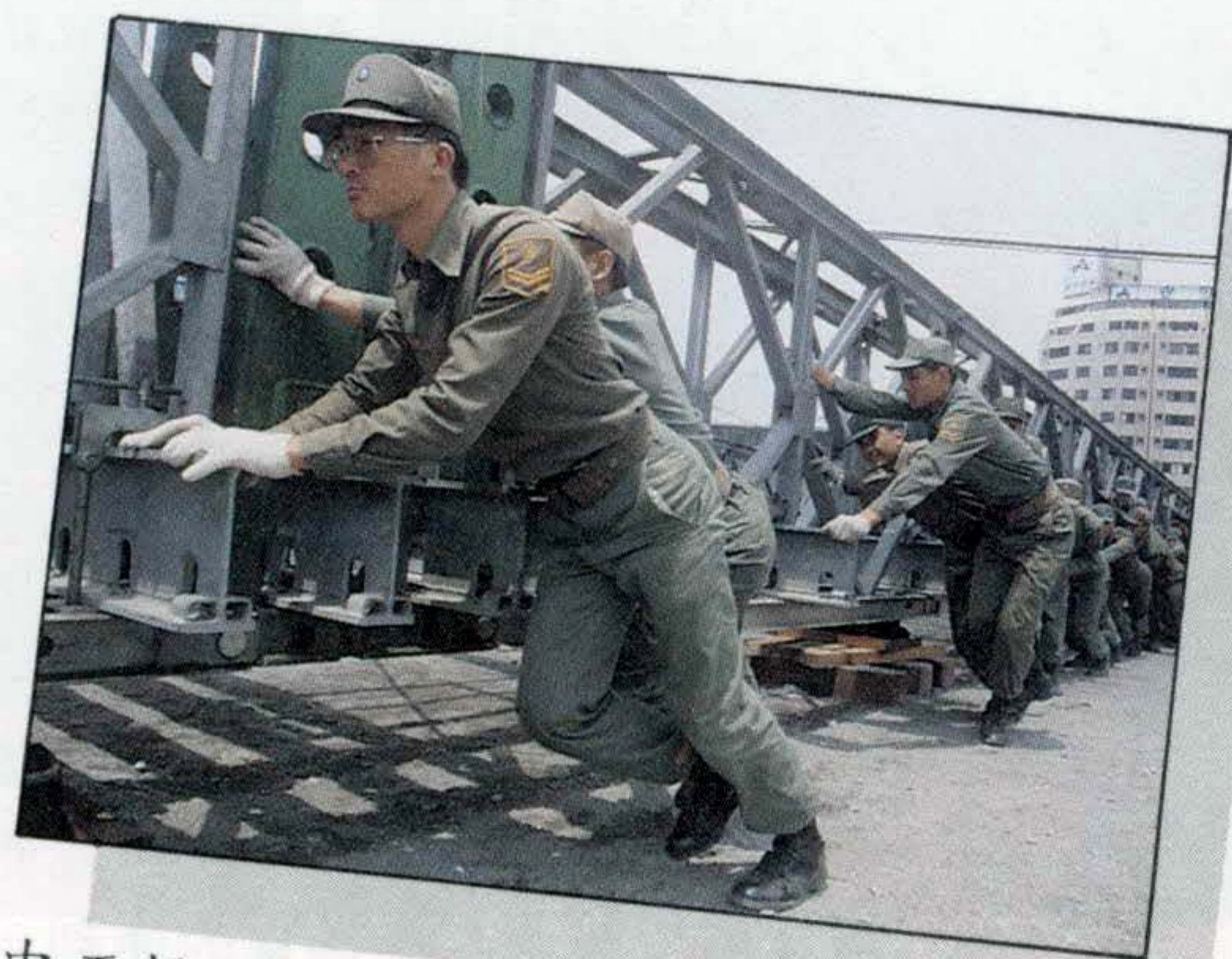
中正橋剛封閉進行改建工程時，動用了一百一十名國軍官兵揮汗搭起倍力橋，以疏解該處交通流量。
