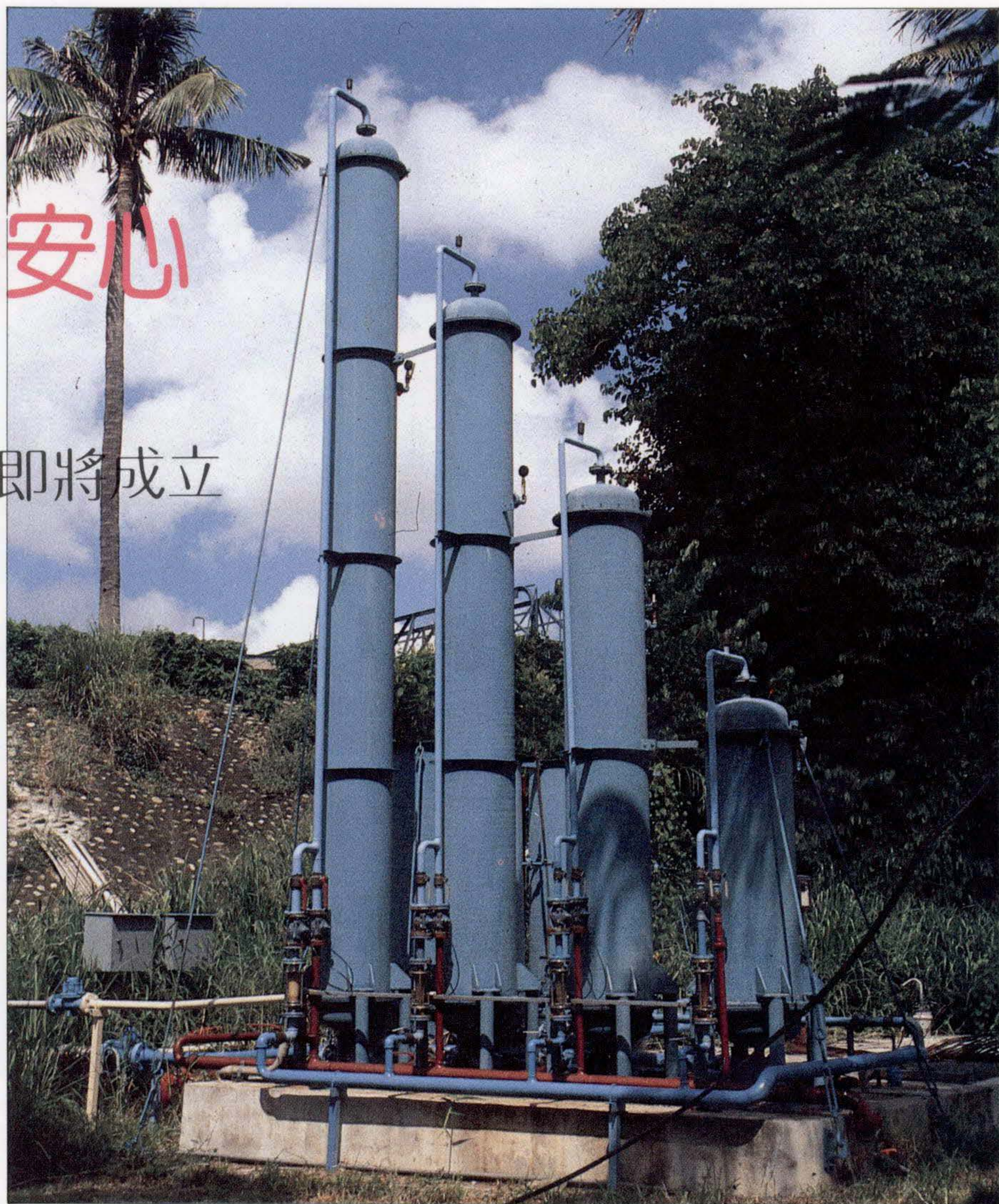
澄清湖集水廠的過濾設備一景
