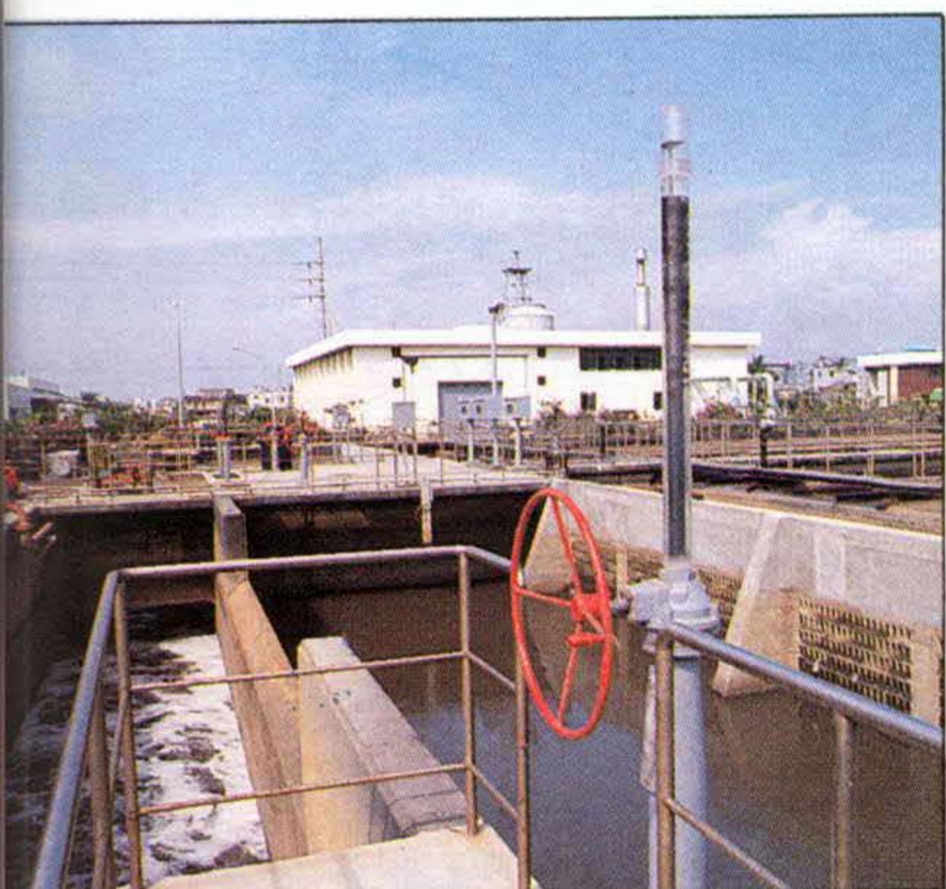
中洲污水處理廠濾水池。
