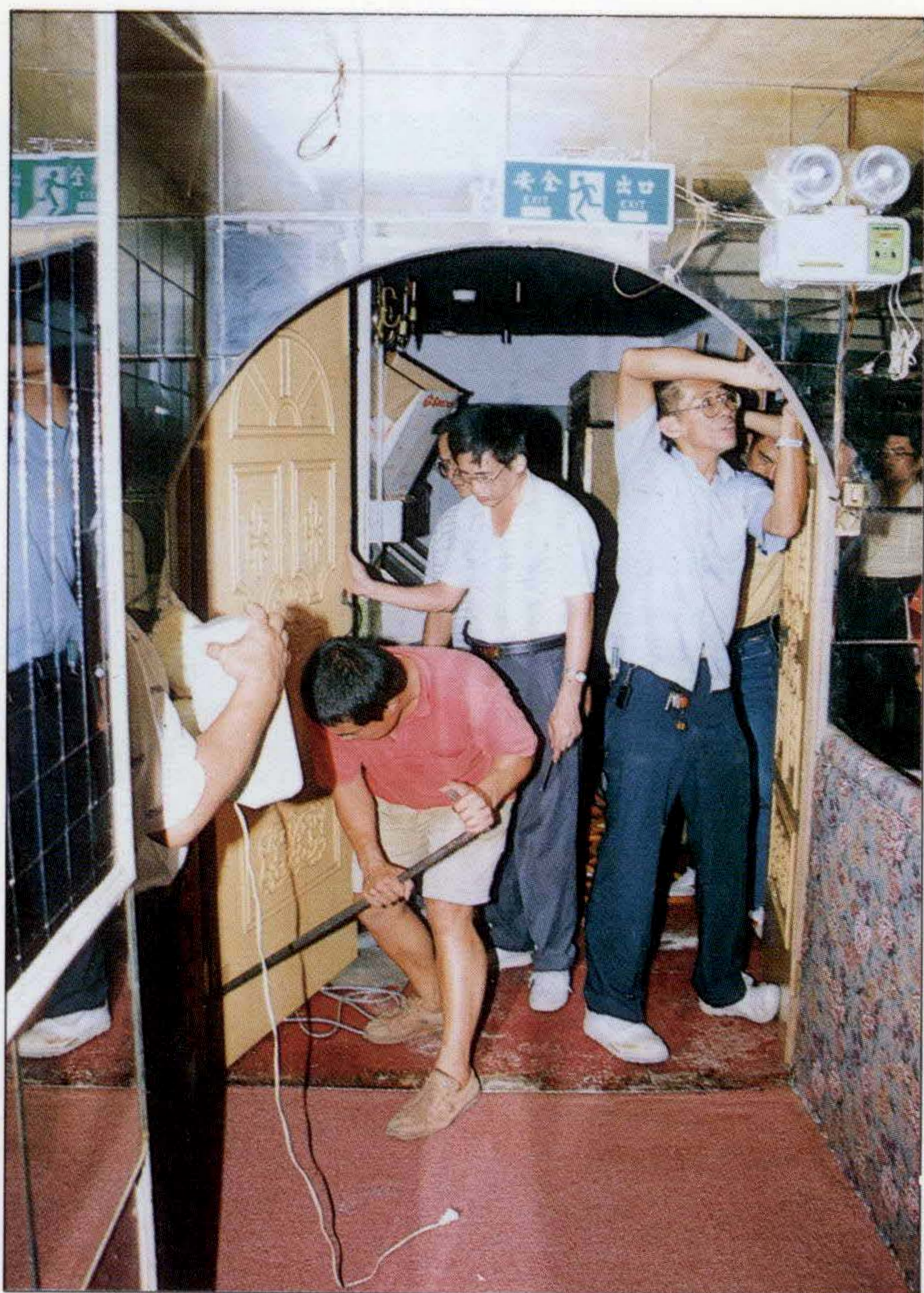
△拆除阻礙逃生之私設安全門。(史德修攝)
