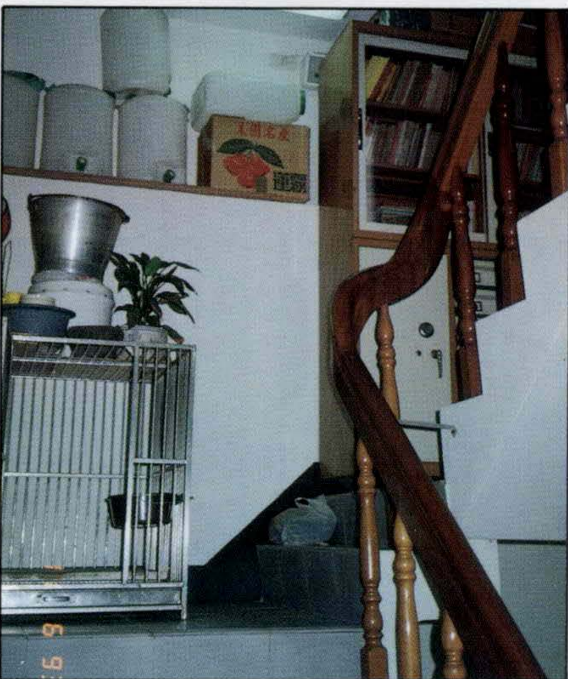
△樓梯通道請勿放置雜物，以免影響逃生通道之暢通。(建管科提供)
