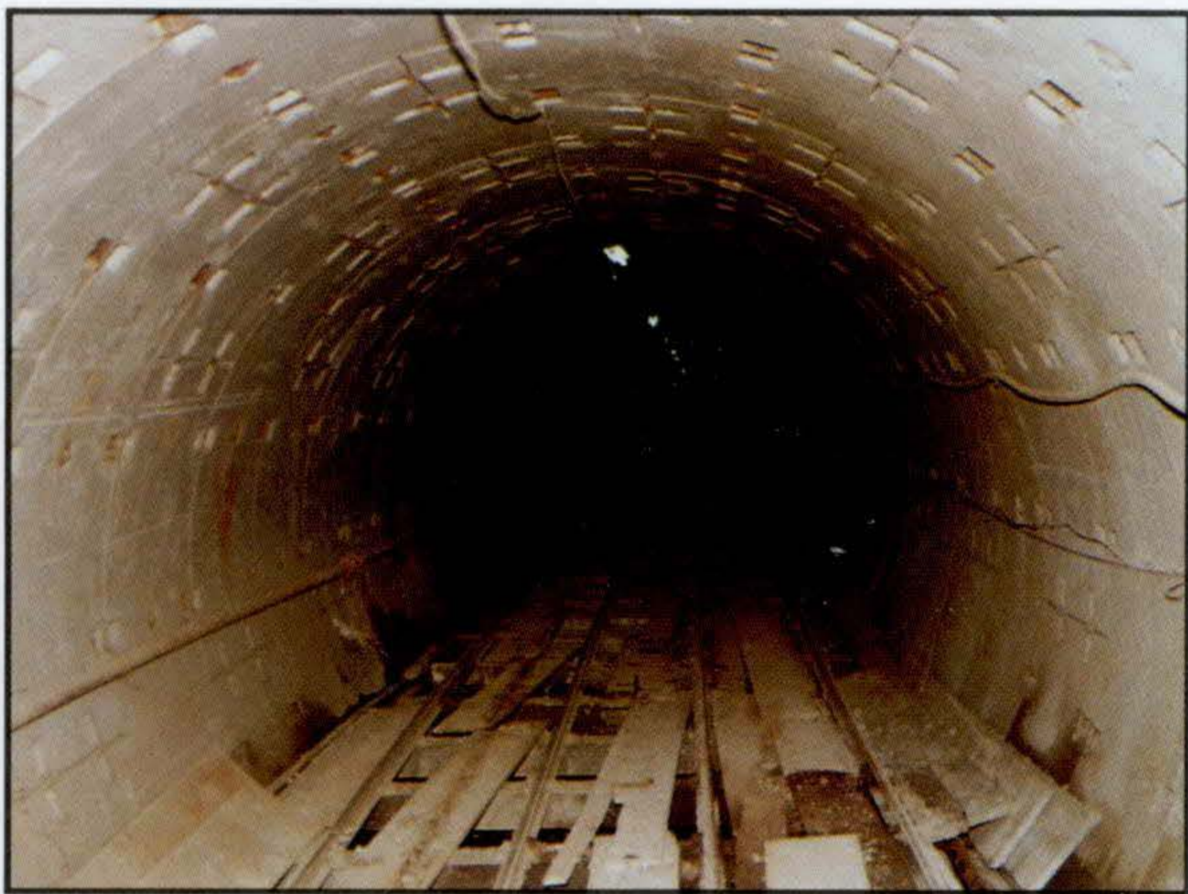
（史德修攝） 同盟路排水幹管。
