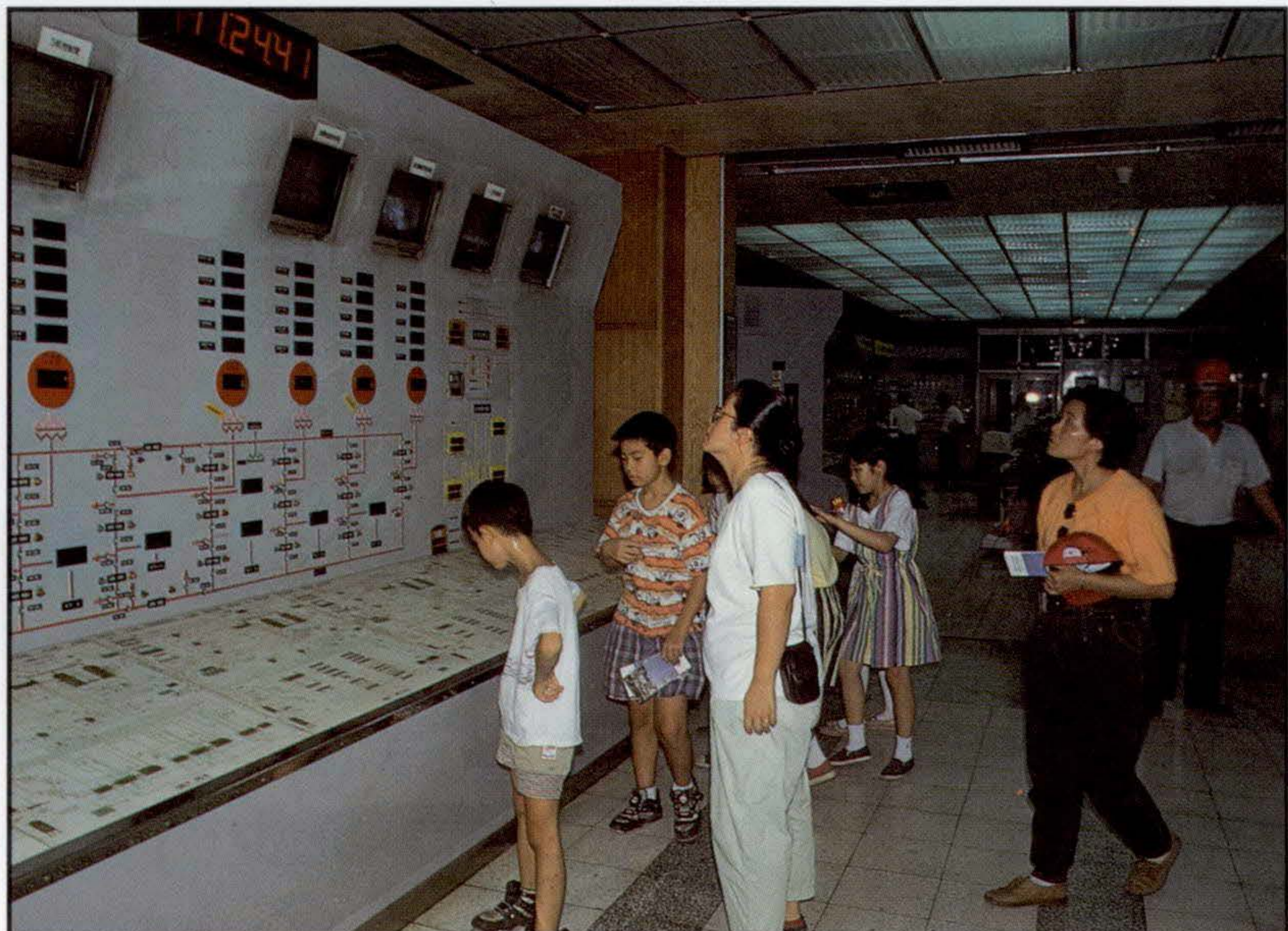
參觀大林火力發電廠的控制室。
