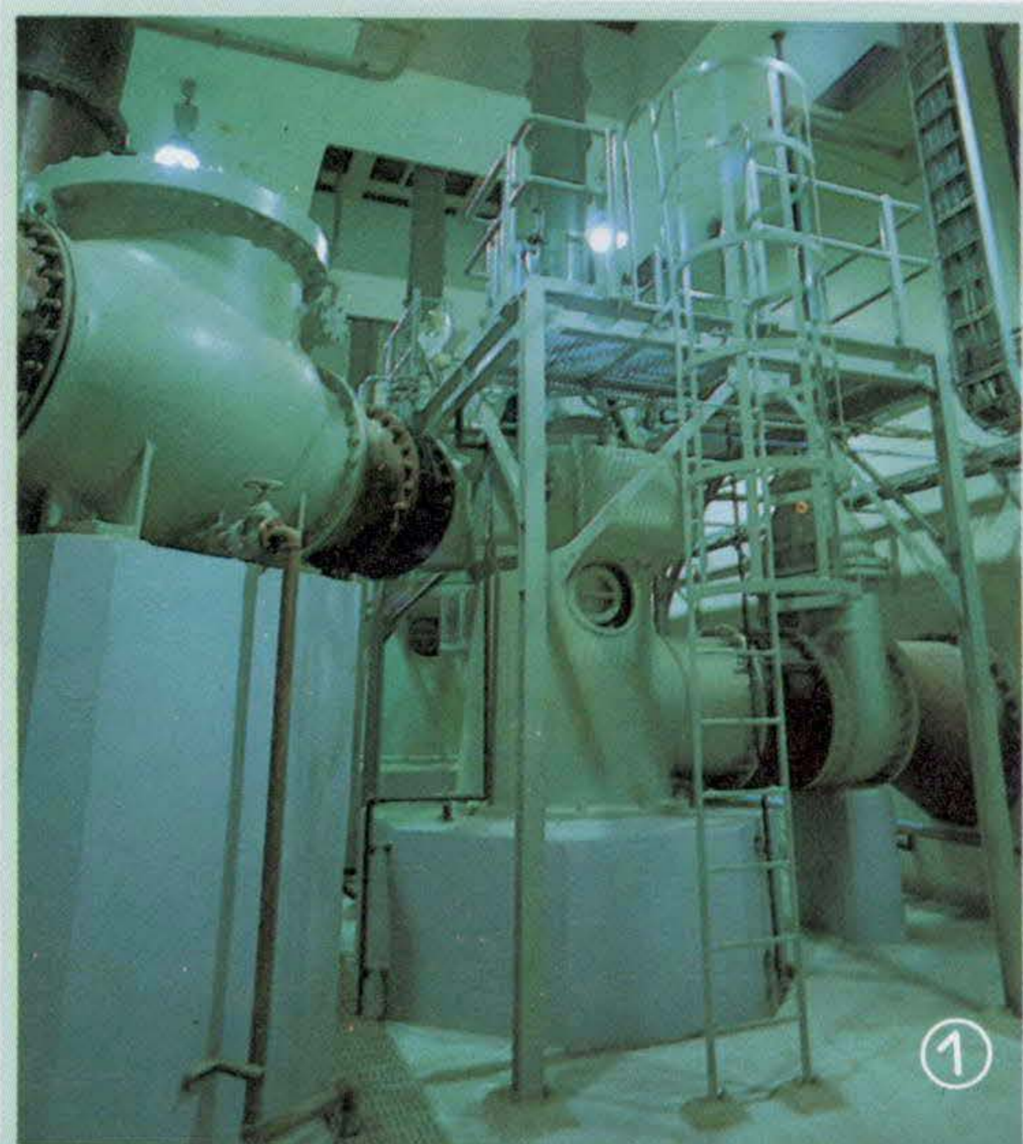
①中洲污水處理廠設備。 ②中洲污水處理廠外貌。
